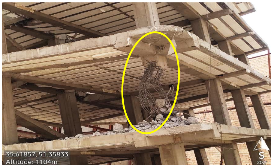
شکل ۴۳- کیفیت نازل بتن و ضعف در آرماتورهای عرضی در مقطع تخریب شده ستون
