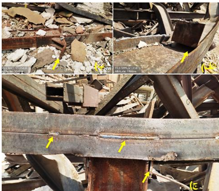
شکل ۳۸- اجرای نامناسب اتصالات برخی سازه‌ها در محدوده الف) عدم جوش کافی در نشیمن نشیمن تکیه‌گاهی تیر به ستون، ب) ایراد در جوشکاری ورق نشیمن تکیه‌گاهی و همچنین قرارگیری نامناسب تیر بر روی آن ج) جوش نامناسب و به دور از ضوابط ستون‌های دویل (فاصله و ابعاد جوش)، همچنین، عدم جوش مناسب نشیمن تیر به ستون
