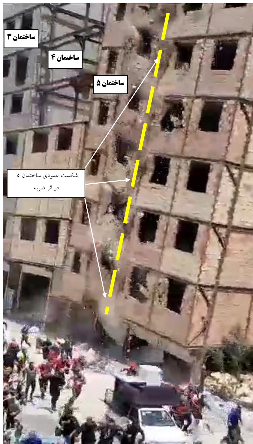
شکل ۶- شکست و دو تکه شدن ساختمان ۵ در اثر ضربه ساختمان ۴ و شکست ستون جنوب شرقی آن (به نظر می‌رسد که این ساختمان پیش‌تر ضعیف شده بود)، نکته مهم از دیدگاه فنی این است که ساختمان ۴ سالم در جای خود باقیمانده است.
