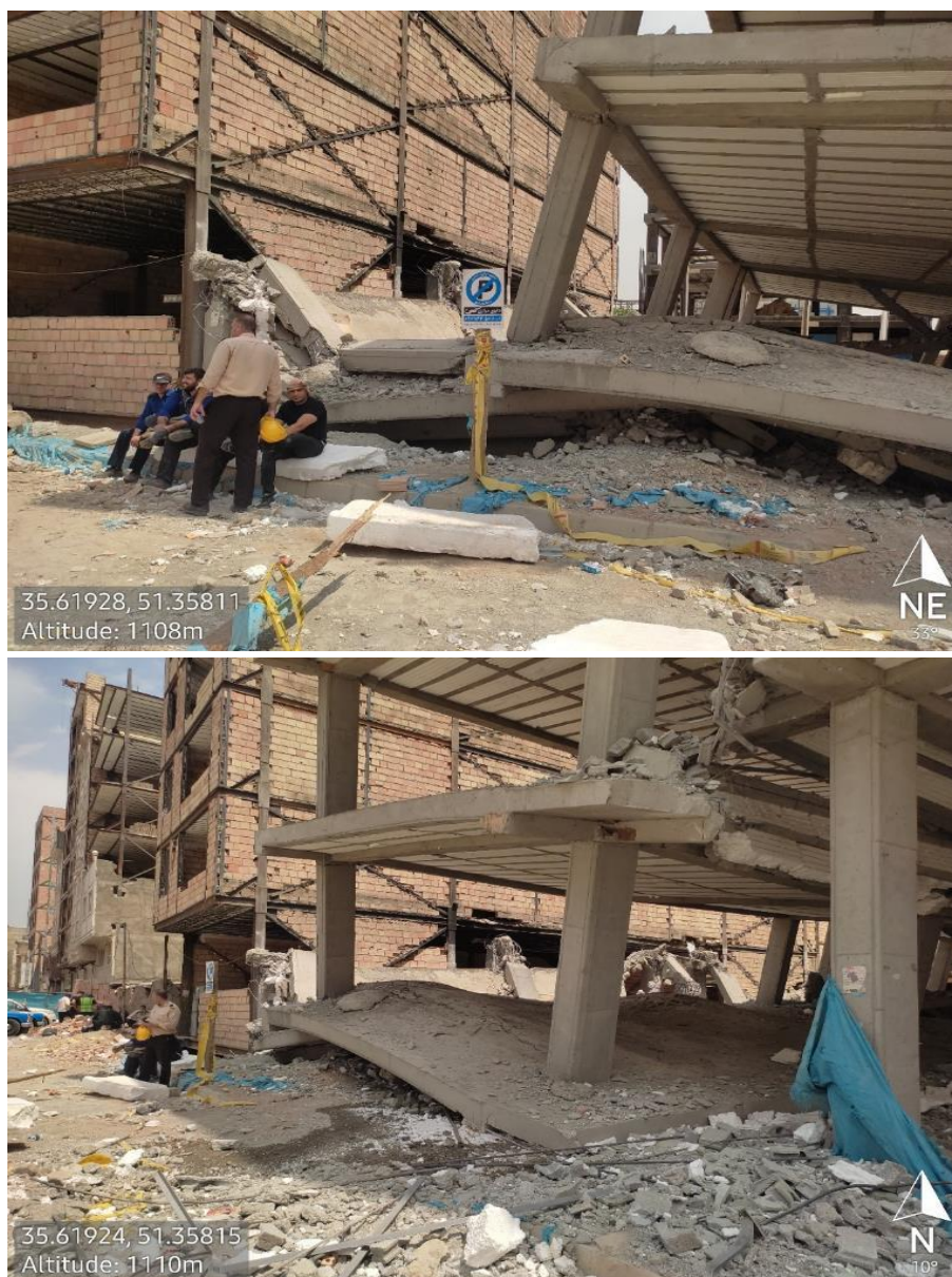
شکل ۳۶- تخریب بخش‌های تحتانی سازه اولیه با فرم پنکیک و واژگونی سازه بر روی ساختمان مجاور
