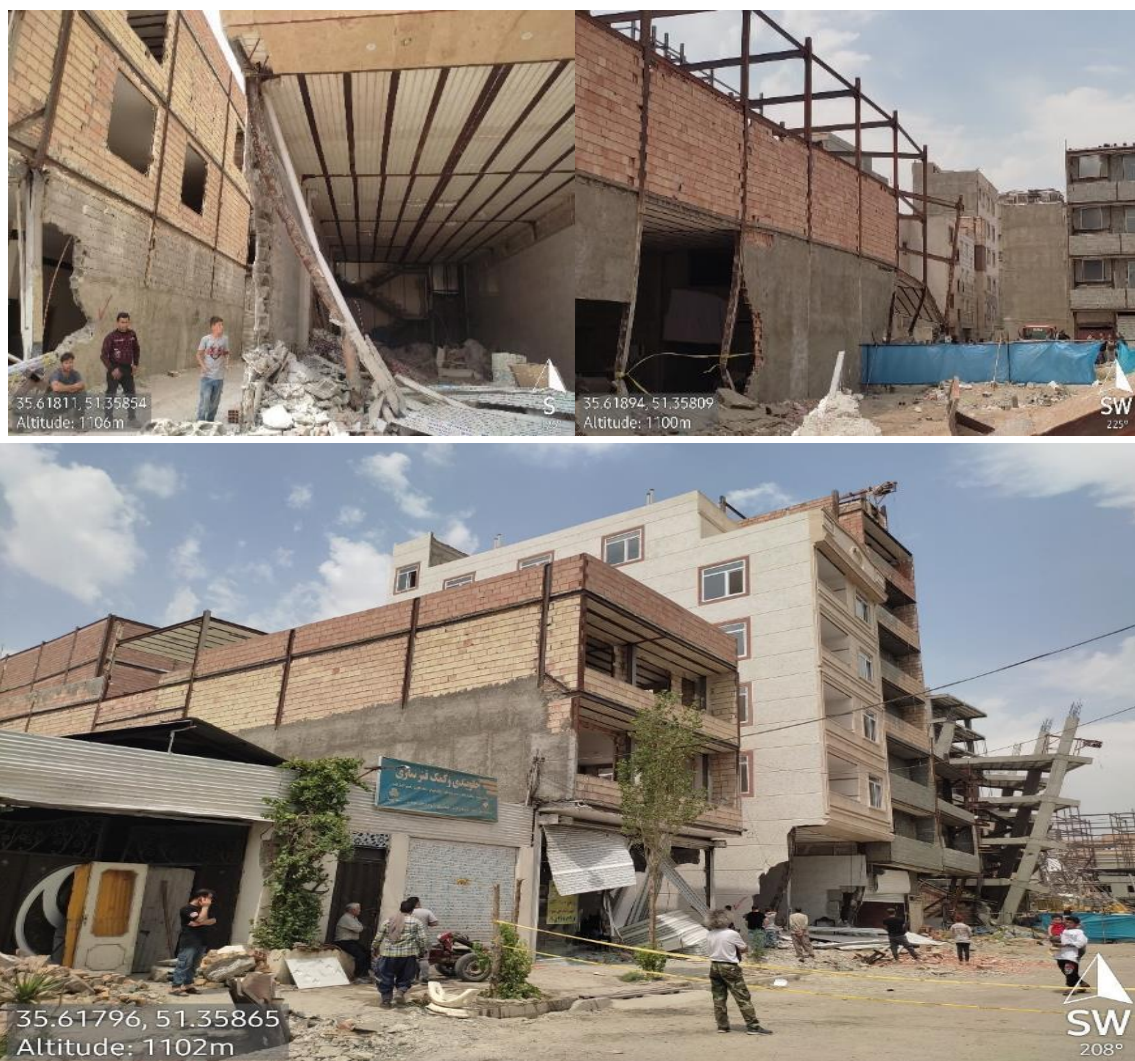
شکل ۳۹- نمونه‌هایی از عدم اجرای مهاربندی جانبی در سازه‌های اسکلت فلزی محدوده
