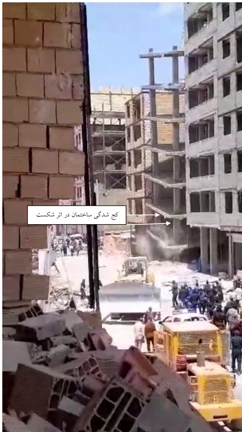
شکل ۴- کج شدگی ساختمان ۱ به سمت جنوب (به طرف ساختمان ۲) در اثر شکست ستون
