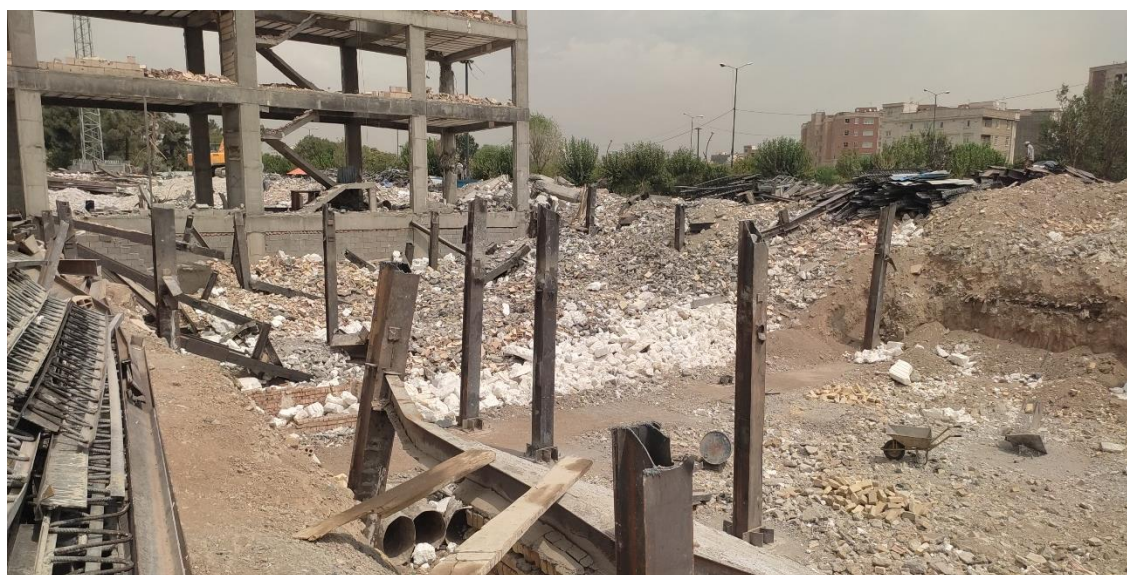
شکل ۵۰- نمونه‌هایی از سازه تخریب شده از طریق برش برخی ستون‌های طبقه همکف و سپس کشش با کابل
