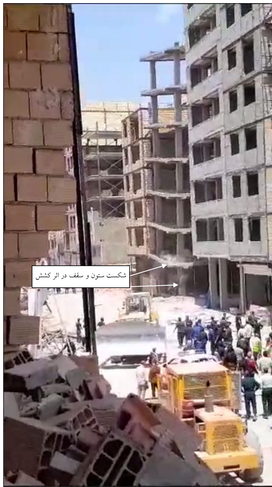
شکل ۳- عکس شکست ستون جنوب غربی ساختمان ۱
