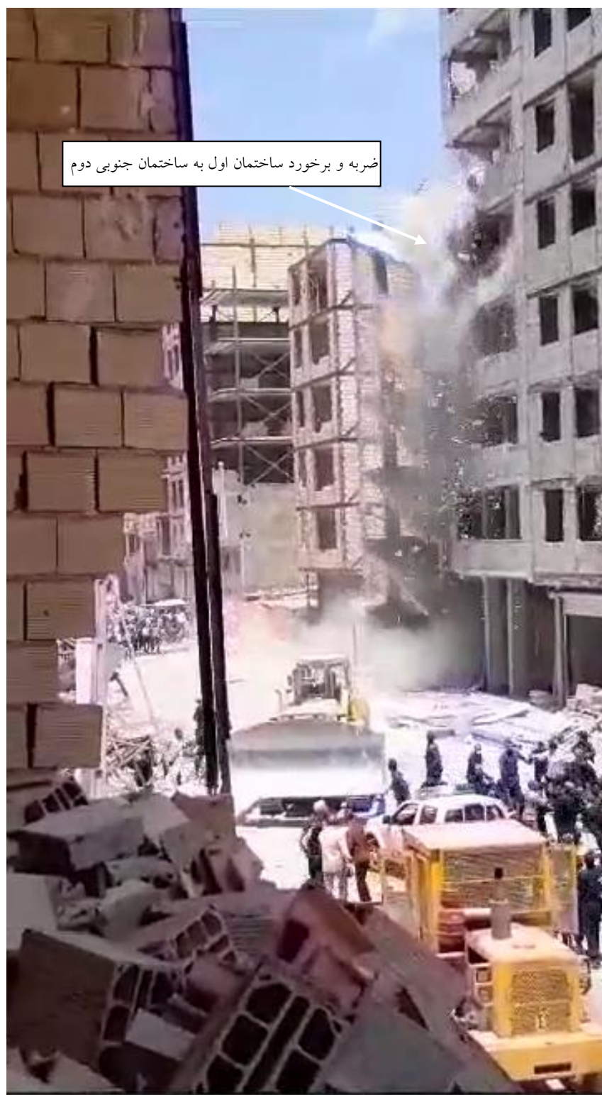
شکل ۵- برخورد ساختمان ۱ به ساختمان ۲ و خسارت بخش شمالی ساختمان ۲
