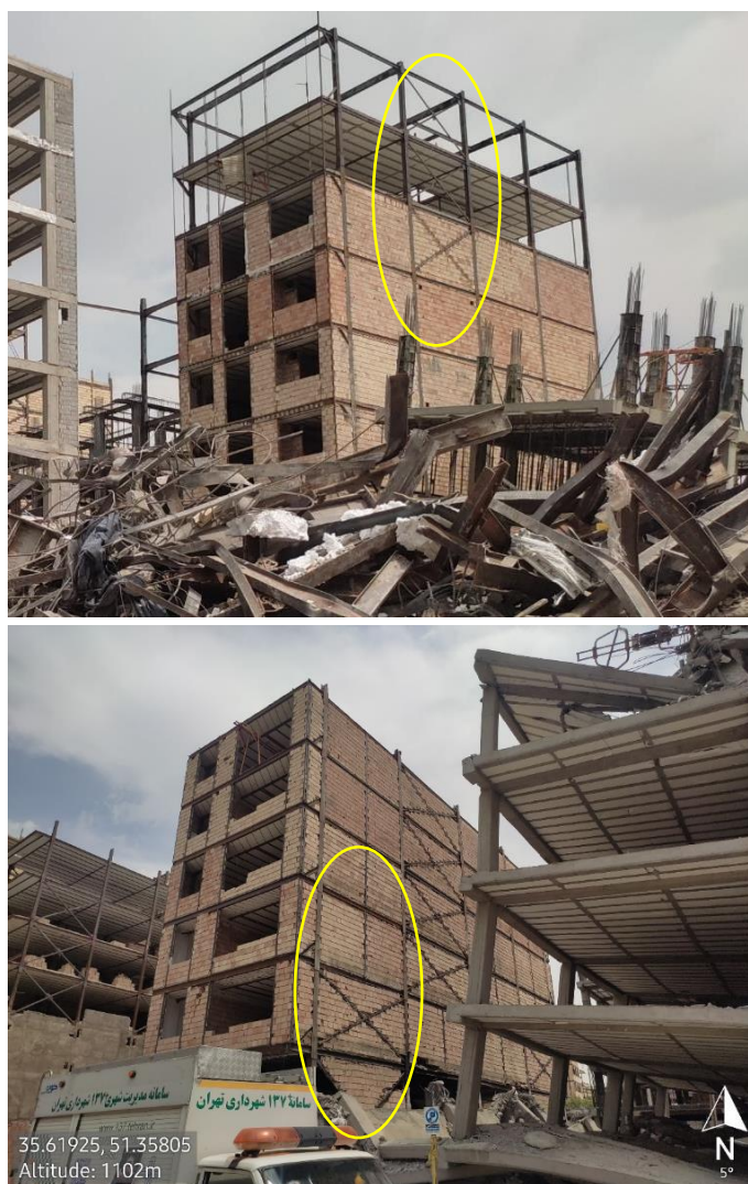
شکل ۴۰- اجرای نامناسب (به دور از ضوابط) اجزای مهاربندی جانبی سازه‌های اسکلت فلزی
