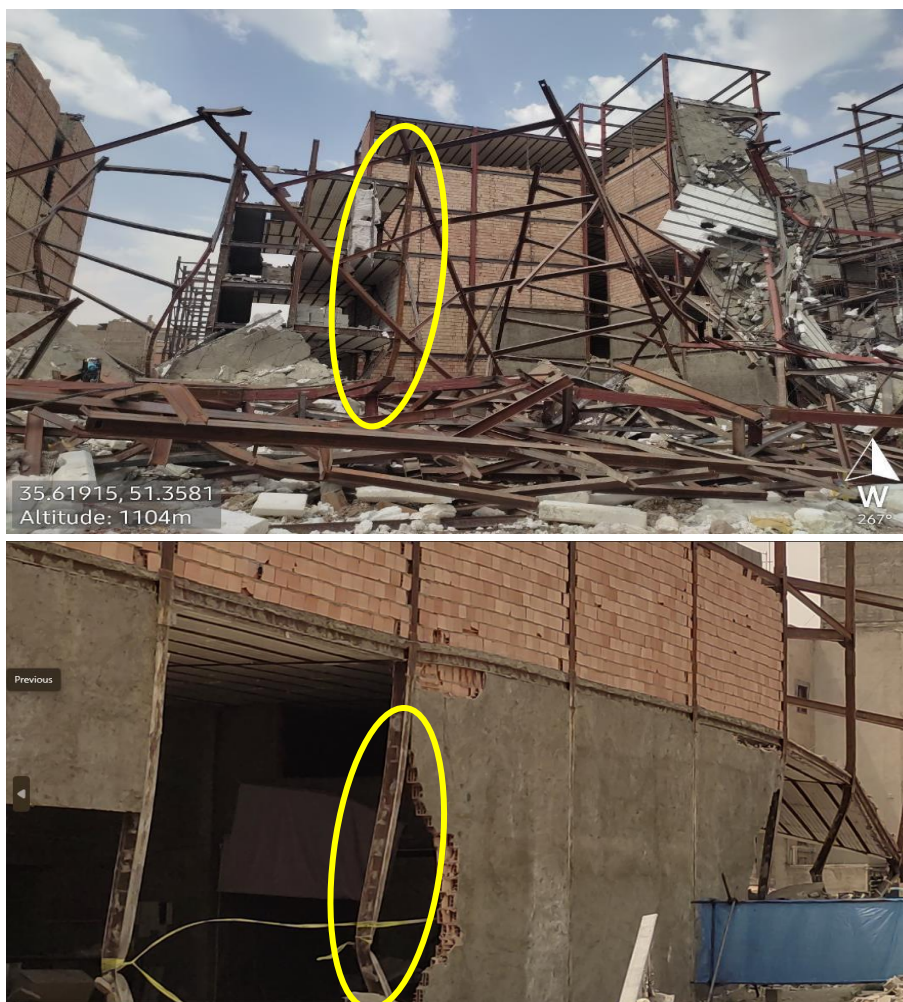
شکل ۴۲- ضعف المان‌های ستون در سازه فولادی ۴ طبقه (بر اساس بازدید چشمی و قضاوت مهندسی)
