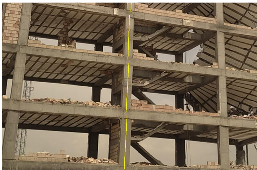
شکل ۴۴- عدم اجرای مناسب آکس ستون‌ها در طبقات مختلف
