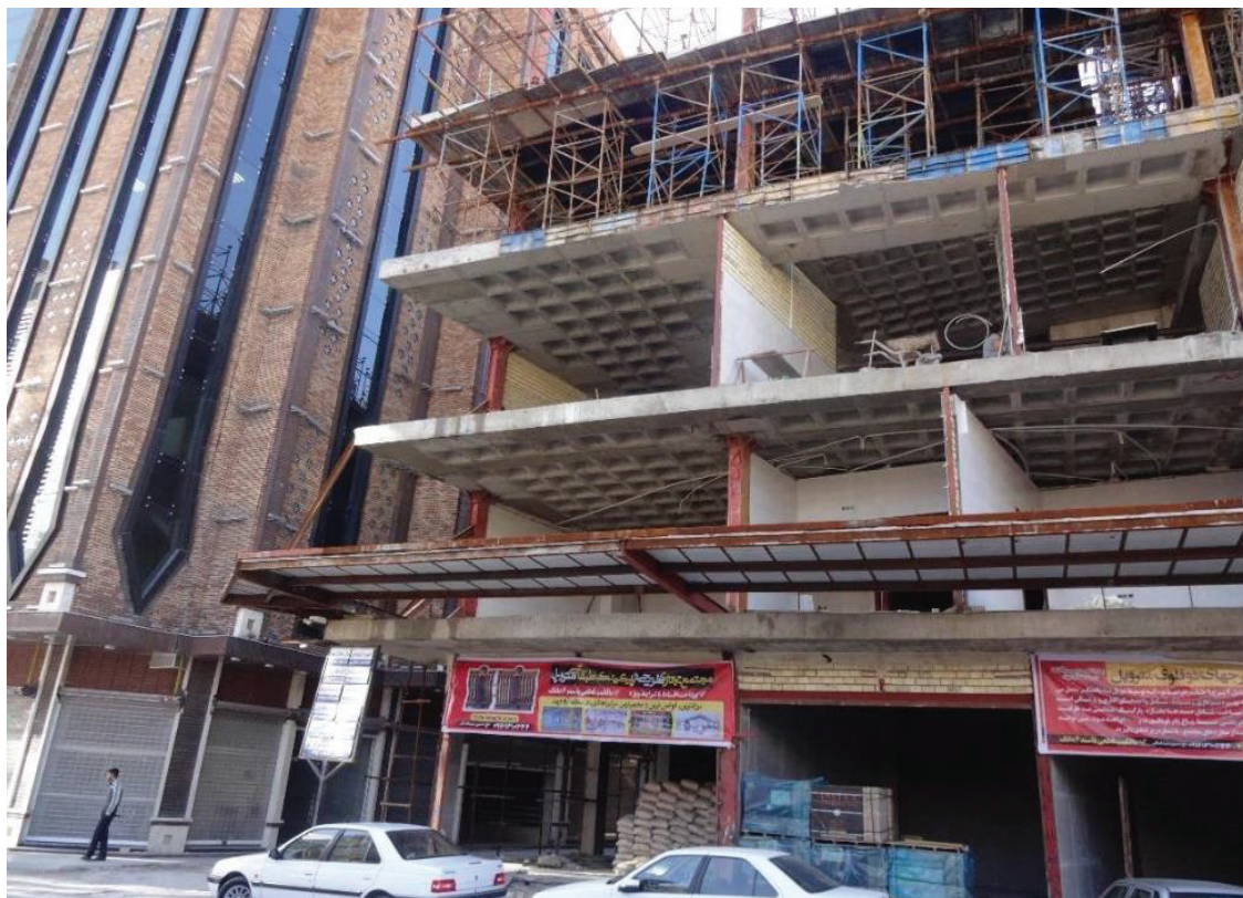
شکل (۱۱) شرایط ساختمان در زمان بازرسی موردی مجددی توسط اداره کل راه و شهرسازی استان خوزستان
