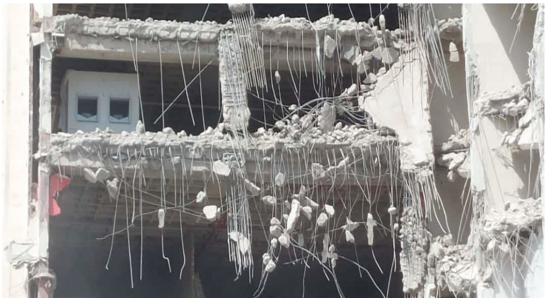
شکل ۱۶) پودر شدن و خرد شدگی‌های بتن به همراه بیرون کشیده شدن کامل میلگردها از بتن (حافظ پور ۱۴۰۱)
