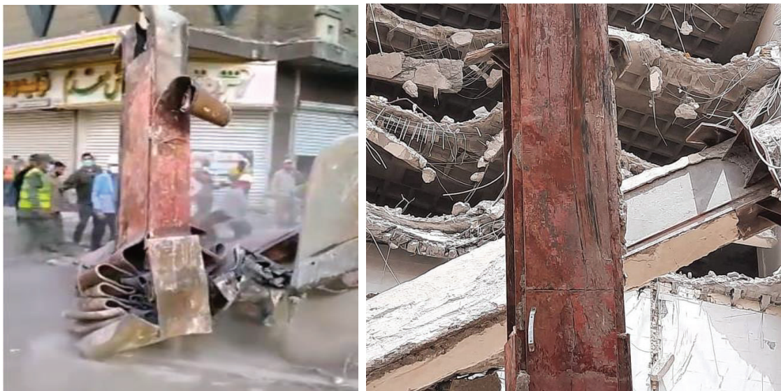
شکل ۱۷) ورق‌های فاقد جوش و اتصال کافی در ستون‌های Built-up
